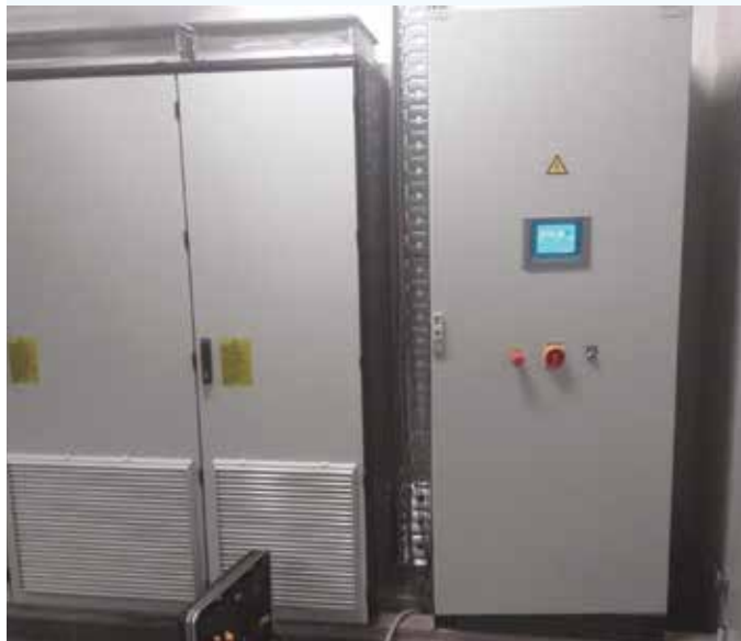
Slika 5: Glavni krmilni blok v strojnici
