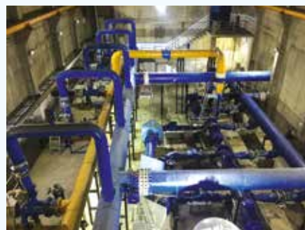
Slika 3: Zgoraj: črpalno postrojenje, ki zajema vodo iz kanala Iber; Spodaj: podzemna galerija z delom naprav za proces mehanske filtracije
